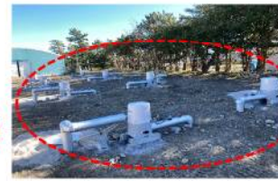
地下100~200メートルの熱を利用 地産地消の熱エネルギー
