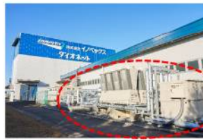
ダイオ袋井工場に導入した 地中熱源ヒートポンプ
