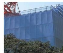
工所用 仮設シート
